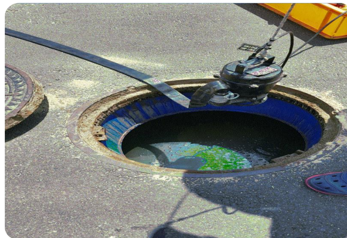
맨홀 침수로 인한 내부 제어반 고장
