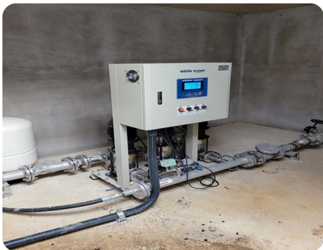
[ 지하 맨홀 펌프 제어반 ]
